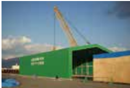
クレーン搬送に最適な一次保管庫として活用
